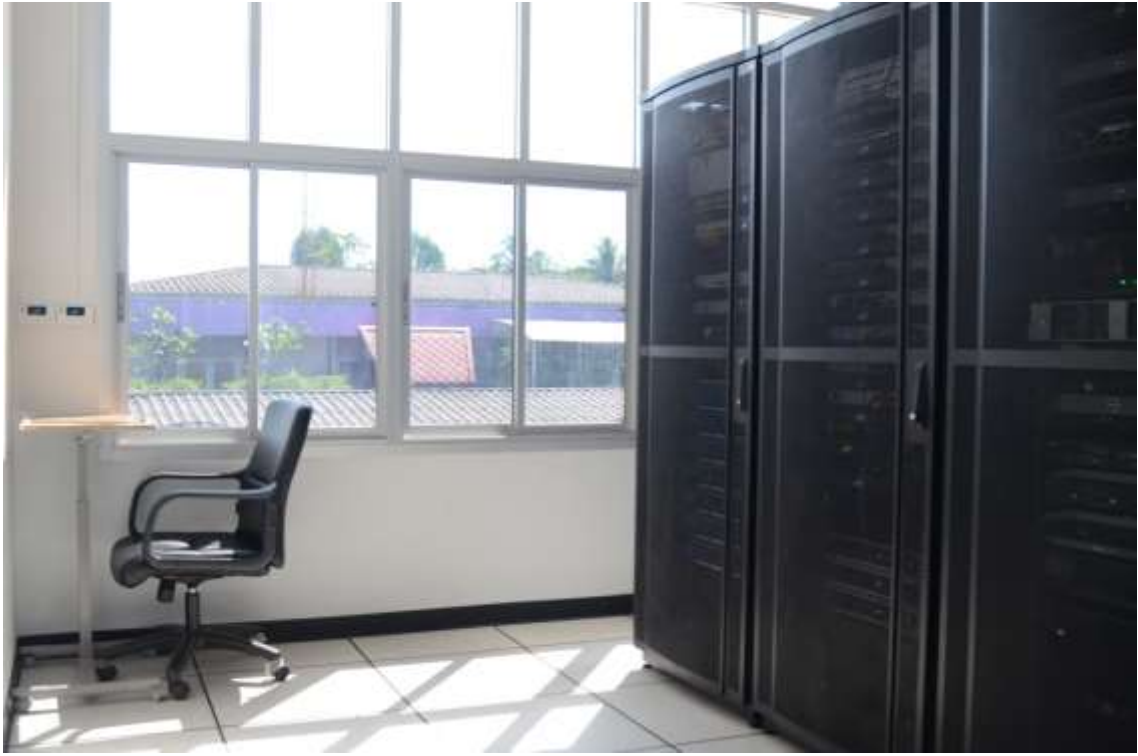
ภายใน ห้อง Data Center (Server Room)
